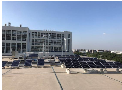
屋顶光伏平台
