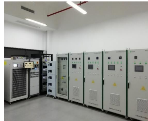
智能微电网实验室
